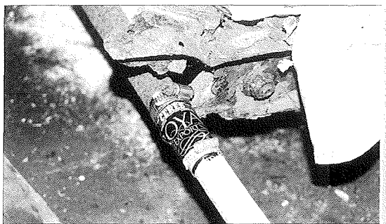
Billede 4: Samling af udstødningsrør og vandrør. . . .
